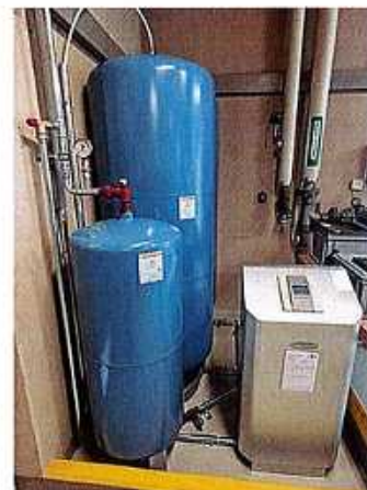
Druckhaltesystem der Heizung
