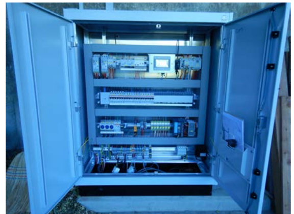
Neuer Elektroschrank PW Kehrmühle
