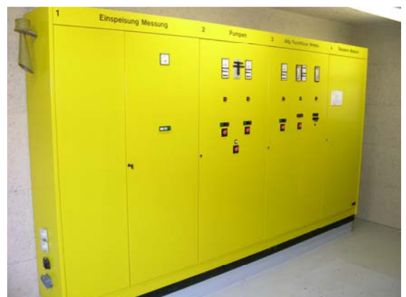
Alte Steuerung Pumpwerk Niederruntigen
