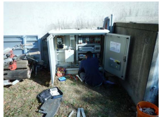
Umgebauter Schaltschrank PW Amtmerswil
