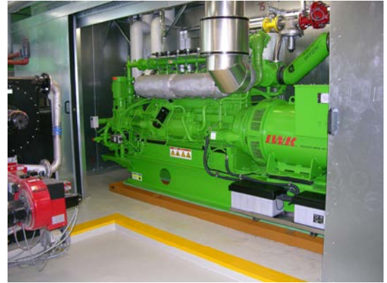
neu montiertes Blockheizkraftwerk
