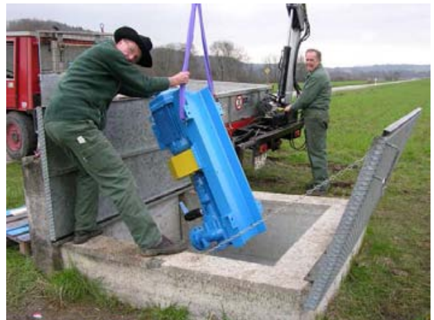
Heikle Einführung der neuen Eggerpumpen in das Pumpwerk
