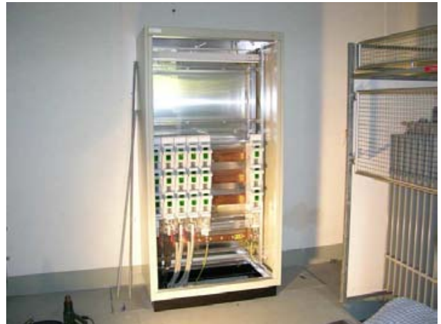
Neue Verteilung mit Abdeckungen
